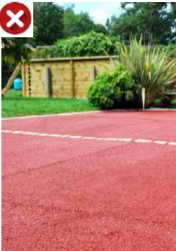
Béton/enrobé trop colorés
